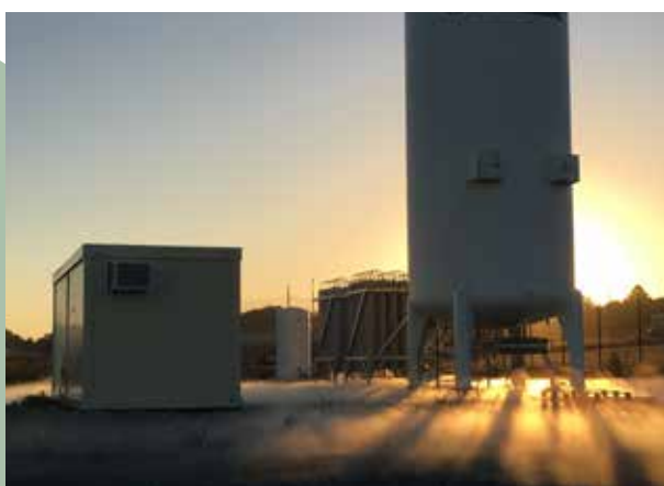
MÉTHABRAYE (41) | ©VERDEMOBIL BIOGAZ
