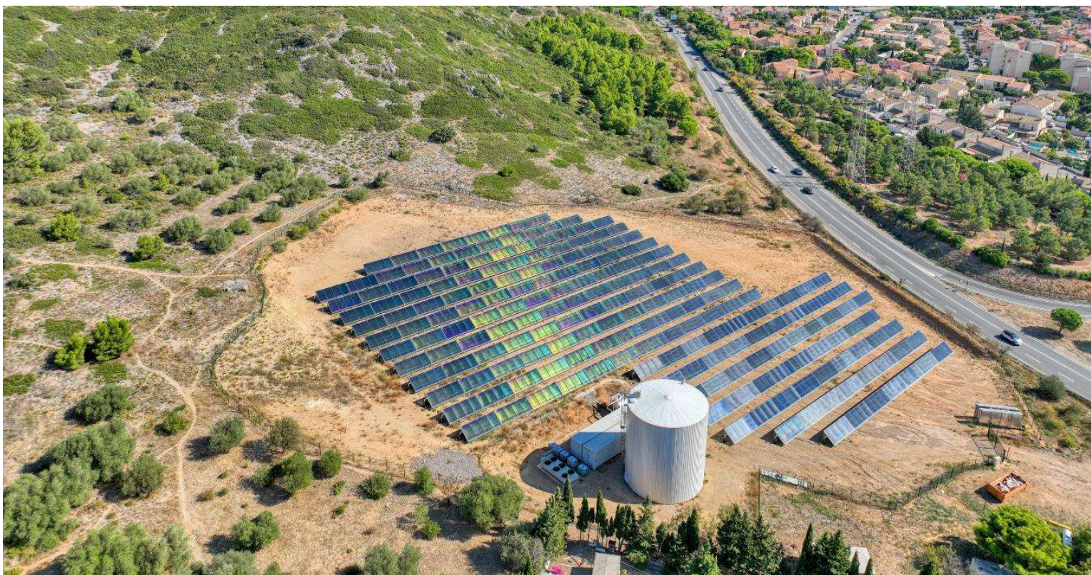
Centrale solaire de Narbosol avec sa cuve de stockage de 1000 m 3 2,3 GWh de chaleur solaire livrée chaque année au RCU de Narbonne
