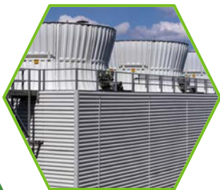
Tours de refroidissement
